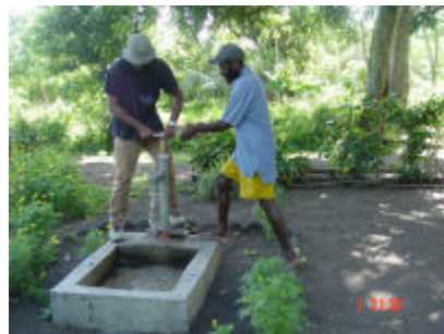
Photo 2 : Exemple d'un puit et d'une pompe à eau installés sur Paama ÓIRD, M. Lardy
